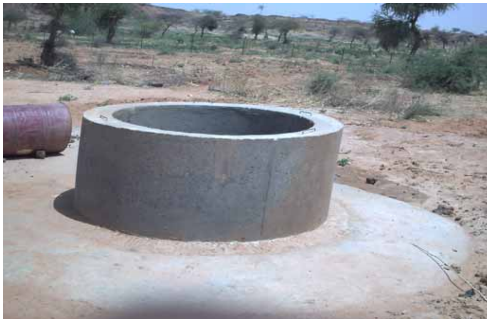
Puits maraîcher bétonné type bi-colonne
