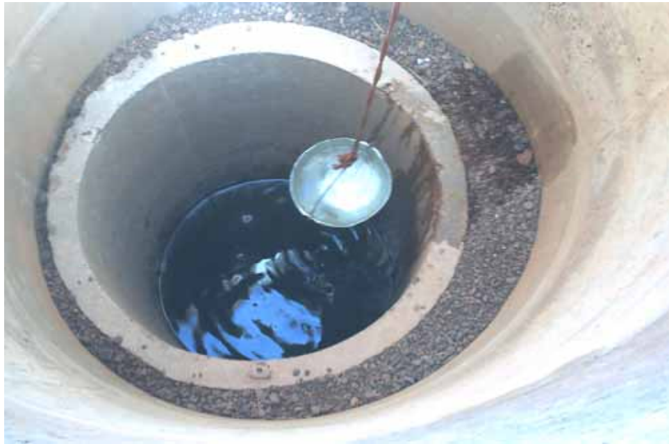
Vue de dessus du fond de puits on distingue le massif filtrant en gravier, la colonne de buses de captage un seau de puisage et l'eau au fond
